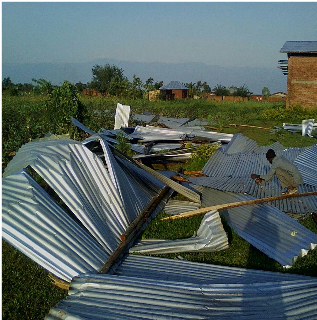
Image des tôles d'une maison détruite
